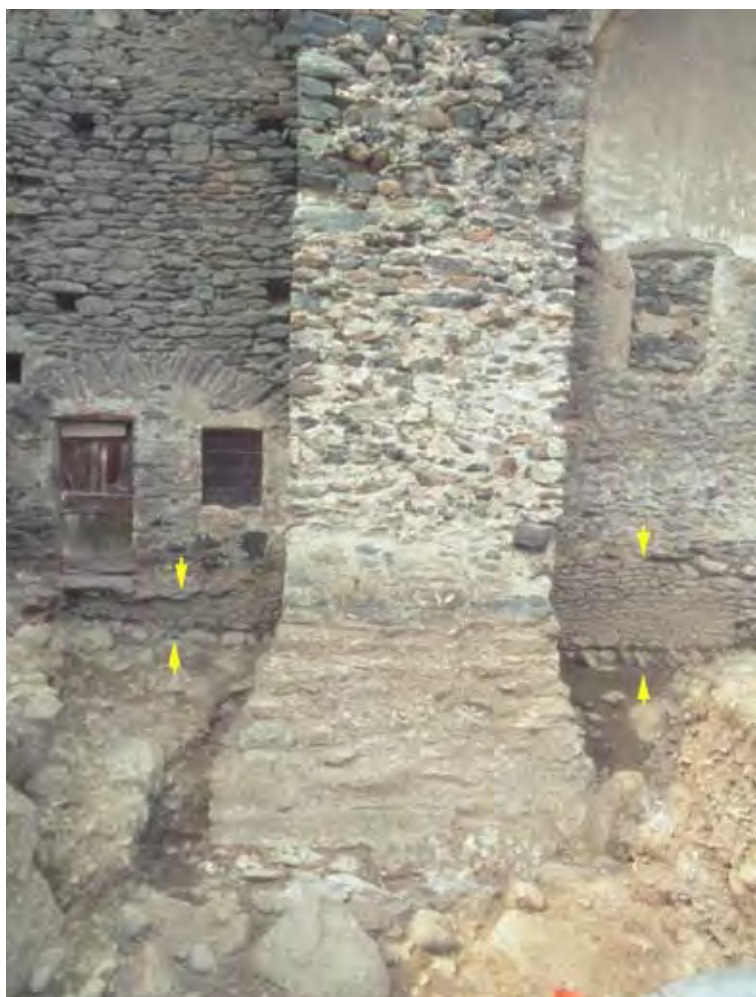
9. Indagine archeologica sulla fronte orientale del castello con individuazione di alcune porzioni di un muro di epoca romana. Settore più a sud sotto le grandi arcate.
