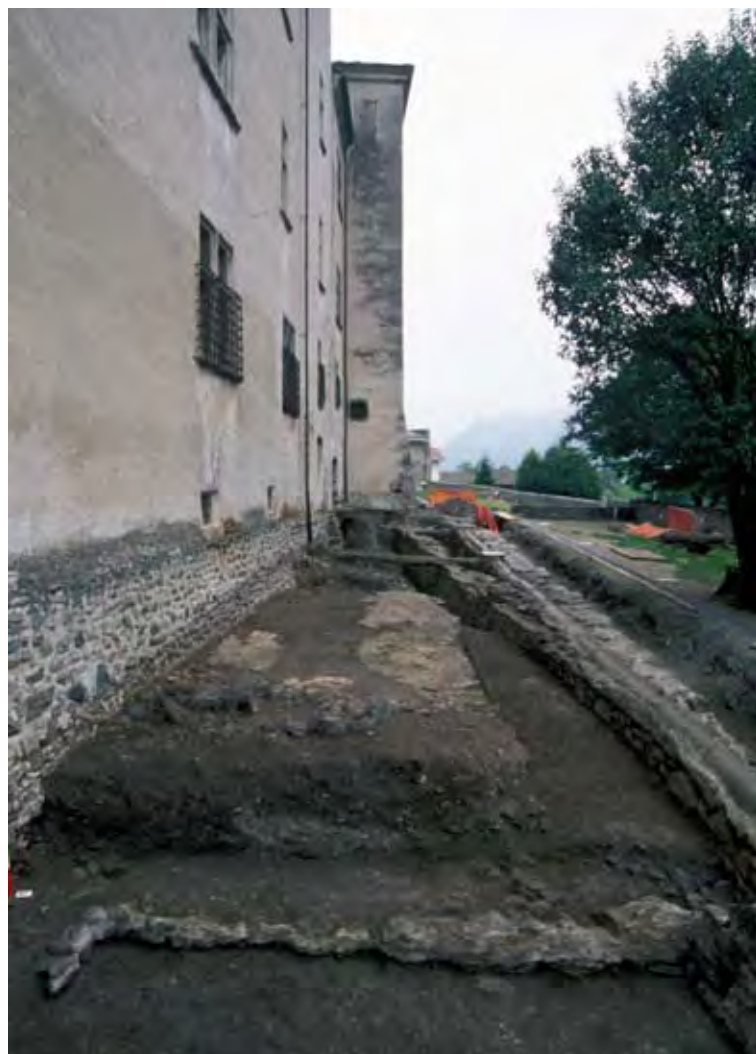
28. Muro di cinta che costituisce l'ampliamento verso est di quello precedente, realizzato rettificando il salto di quota verso valle, creando un preciso parallelismo con la fronte del castello.
